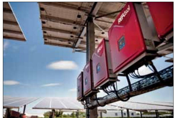
Instalación de 4,6 MW
