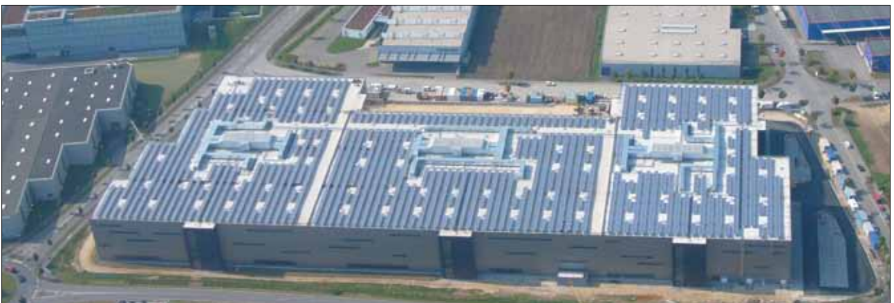
Instalación de 1 MW
